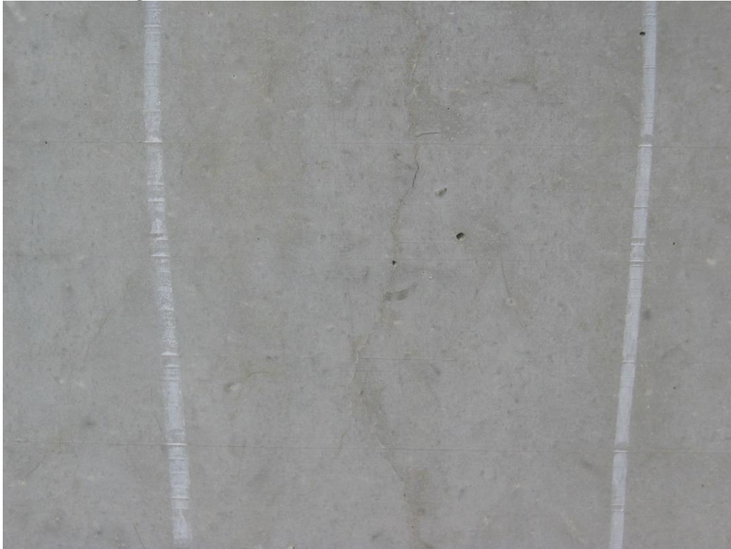
9- Rissbildung an einer Wand
